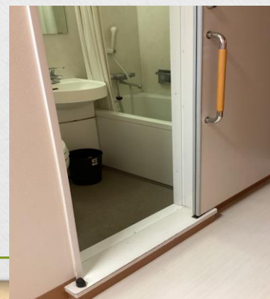
入口段差あります
